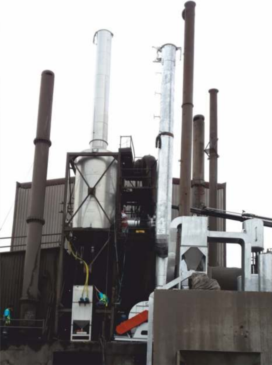
Adapazarı Akışkan Yataklı Kazan Baca Filtre Uygulaması
