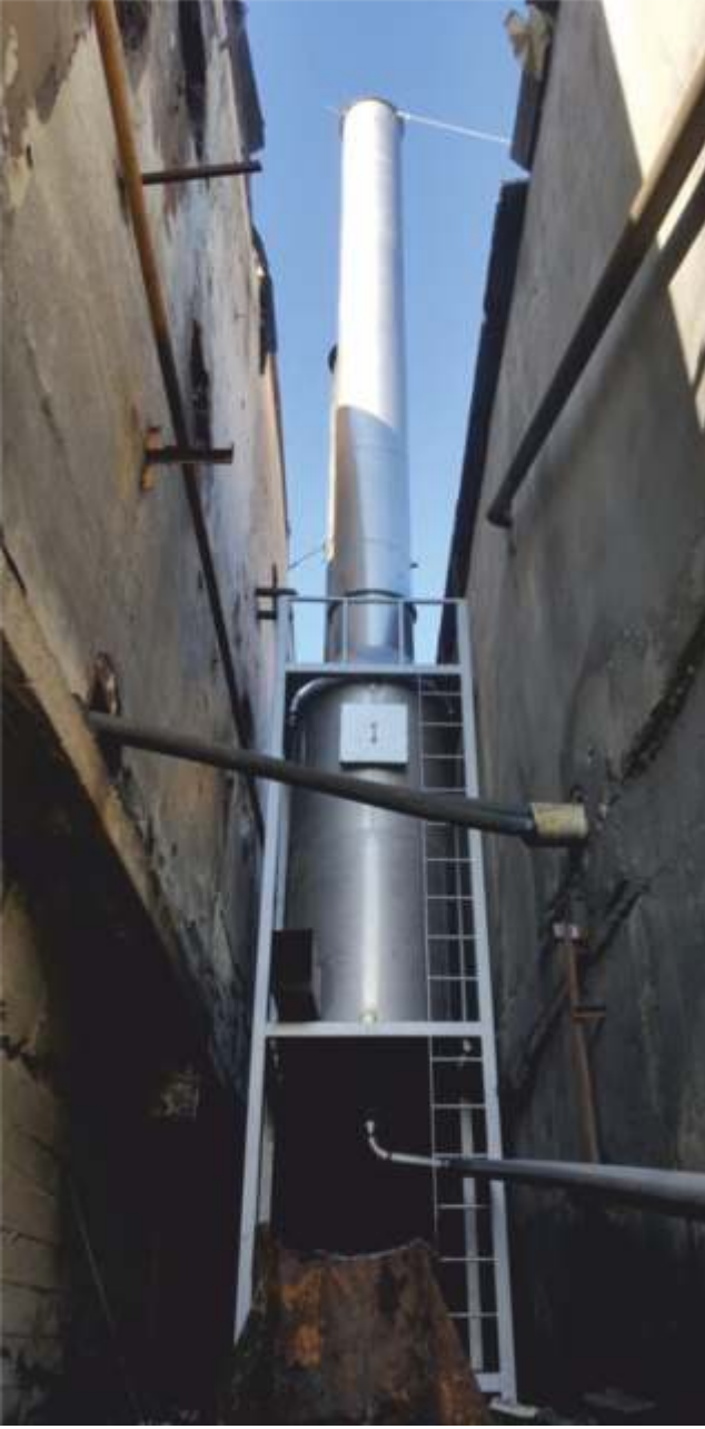
4 MW ve 6 MW İstanbul Kıraç Baca Filtresi Uygulaması
