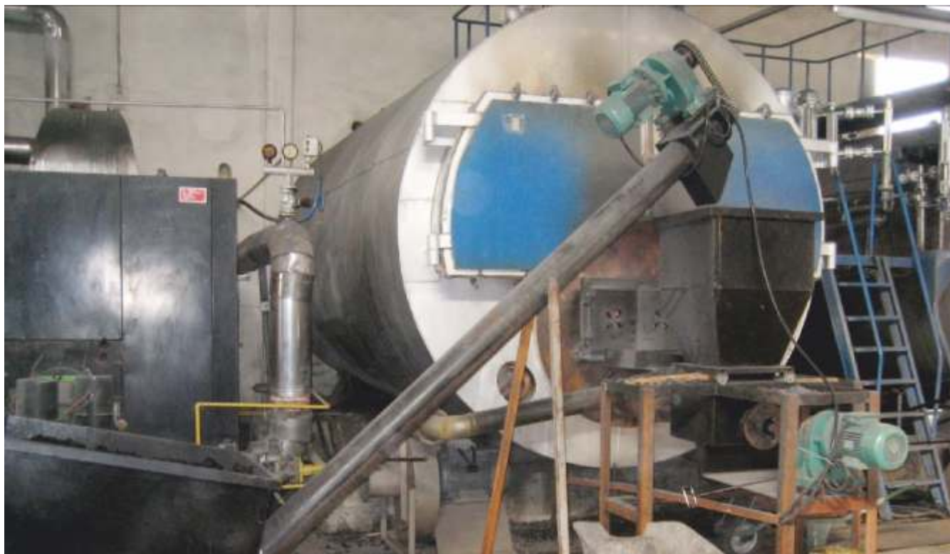
PROTO LTD PLOVDIV / BULGARİSTAN LNG den kömüre dönüşüm yapılarak %60 tasarruf sağlanmıştır.
