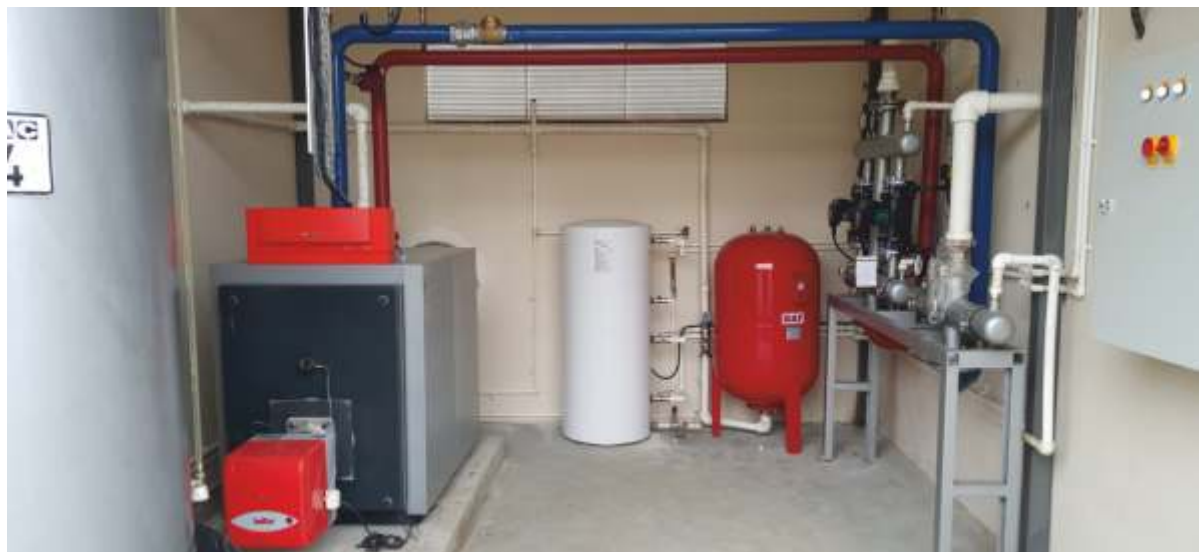
( İstaç ) 250 kW gücünde kazan - boyler - kollektör iç tesisatı
