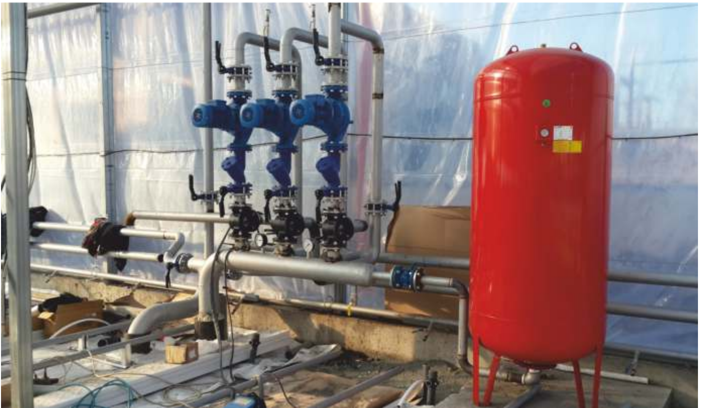
Ara İç Sirkülasyon Pompaları Kollektör Sistemi
