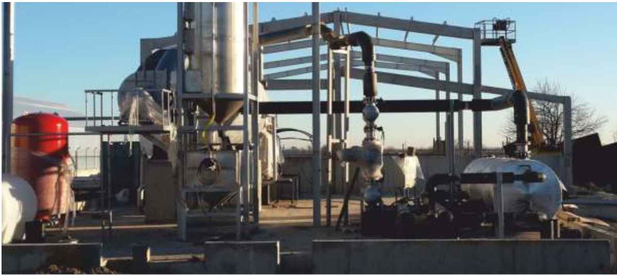
( Bio Zagora ) 6.500 kW gücünde kazan - boyler - kollektör iç tesisatı
