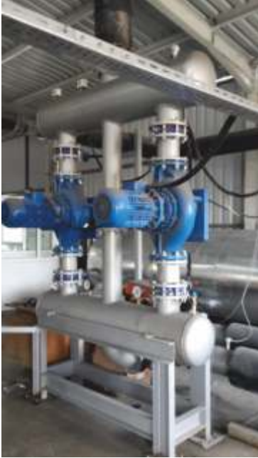
Ana Sirkülasyon Pompaları Kollektör Sistemi
